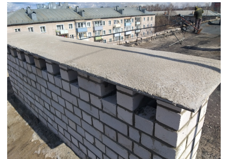
Ул. Пушкина, 32А. Выполнены работы по демонтажу и кладке вентиляционных шахт (были демонтированы и сложены абсолютно все вентиляционные шахты), объект сдан
